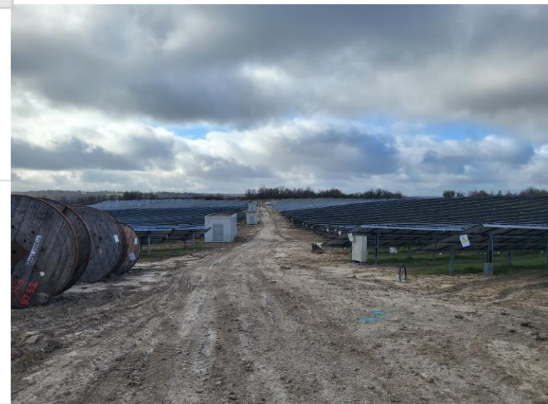
Exemple de piste lourde sur la centrale solaire de Sycala (Lot)
